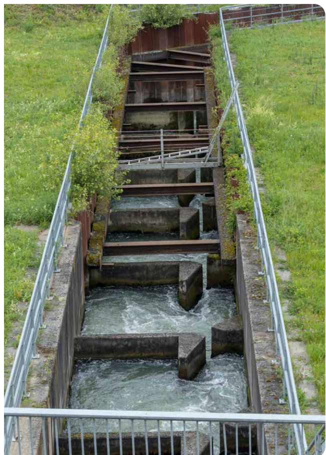
Fischtreppe Iffezheim am Rhein
