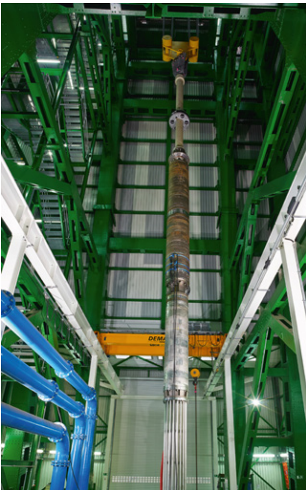
Bild 11.7 – Tauchpumpe Zentrale Wasserhaltung Walsum (Quelle: RAG AG, Servicebereich Technik- und Logistikdienste)
