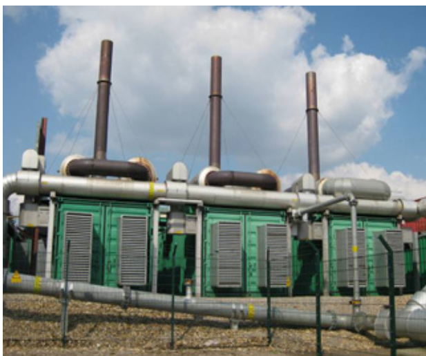
Bild 2.3 – Grubengasverwertungsanlage (Quelle: Bezirksregierung Arnsberg)
